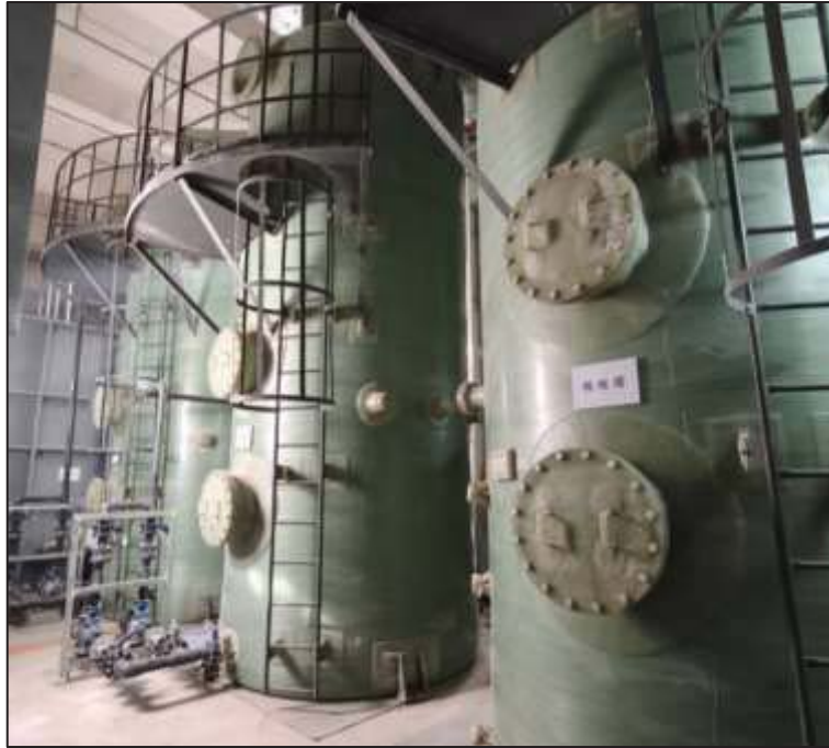
废水处理系统
