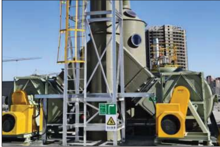
酸性废气处理设施
