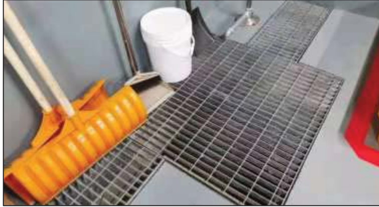
耗材供应车间内泄漏物料收集渠
