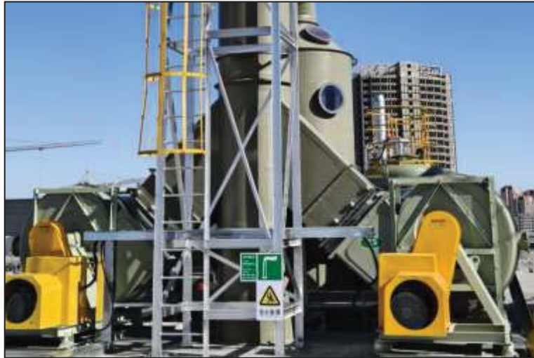
工艺废气处理设施
