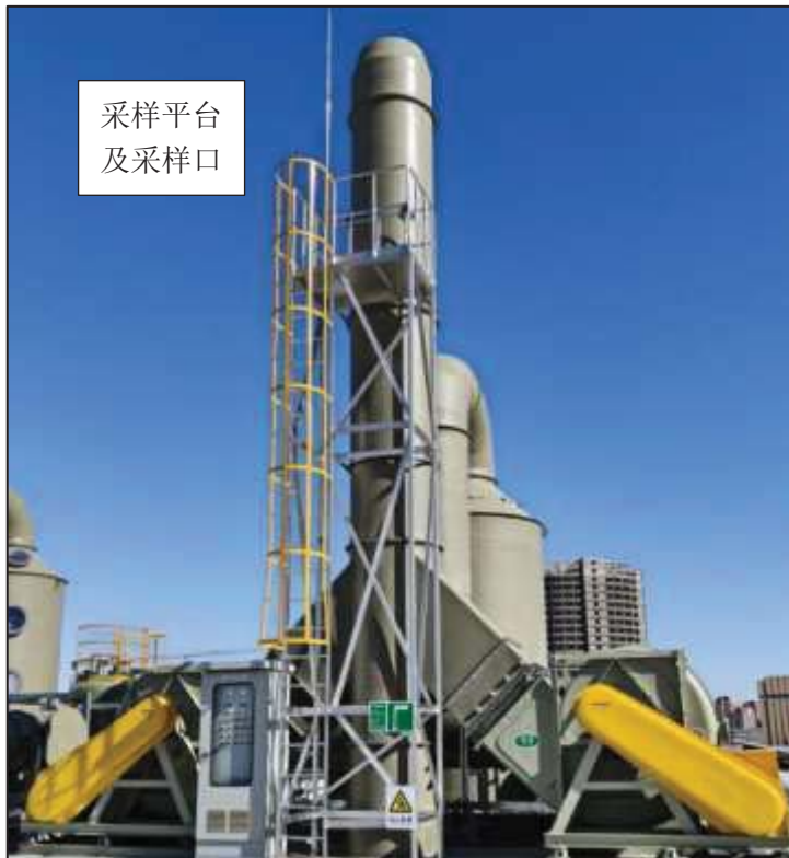
工艺废气排气筒 (DA006)
