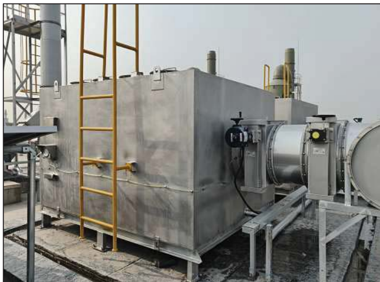
有机废气处理设施
